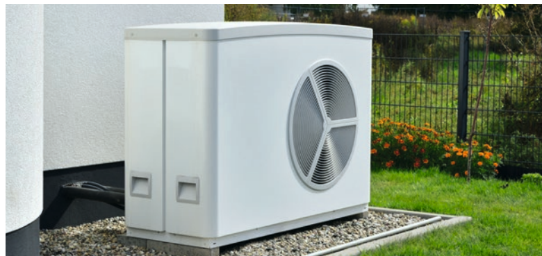
Eine Luftwärmepumpe holt sich ihre Energie aus der Umgebungsluft.
